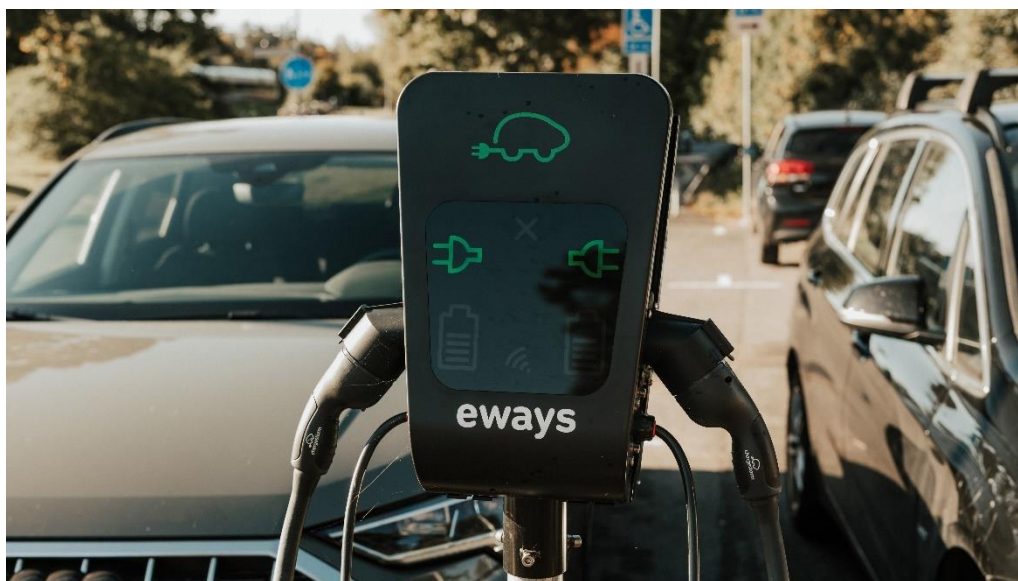
Laddplats på pendlarparkeringen i Storvreta.
